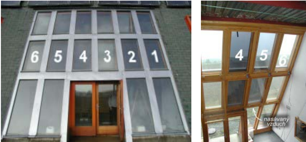
Obr.3 Vnější a vnitřní pohled na sluneční stěnu a vzduchové solární kolektory, instalované v Ekodomu VUES v Podolí u Brna
