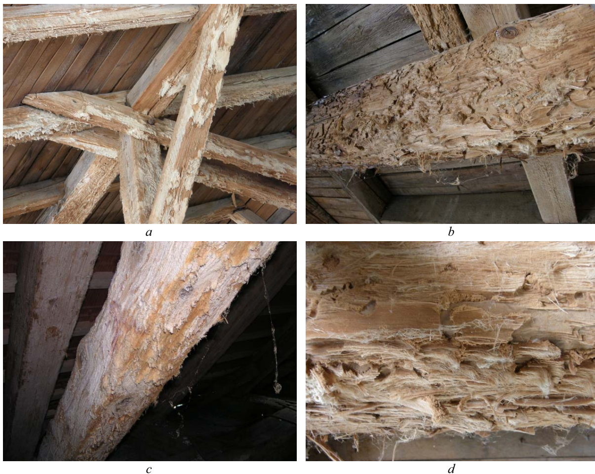
Obr. 1 Konstrukční prvky poškozené chemickou korozi, areál bývalého pivovaru v Děčíně (a,b,d); administrativní budova v Praze 1 (c).
